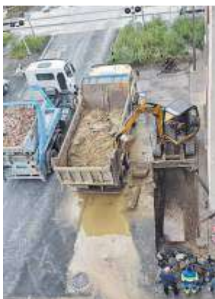
Imagen del lugar de la rotura
